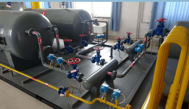
油气集输实训室
